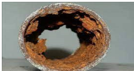
Рис.1. Прояви корозії на ділянках трубопроводу.
