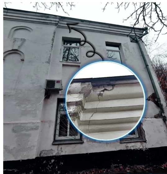
Рис. 2. Тріщини в стінах лікарні (Першотравневий пр., 20) через просадки лесової основи
