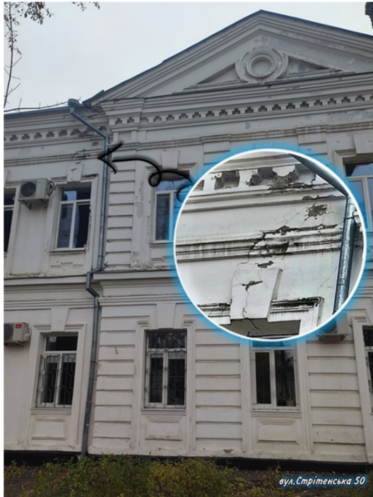
Рис. 1. Тріщини в стінах будівлі (вул. Стрітенська, 50) внаслідок просадок лесової основи
