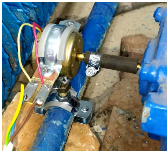
Рисунок 1 – Тахогенератор, встановлений на двигуні лебідки
