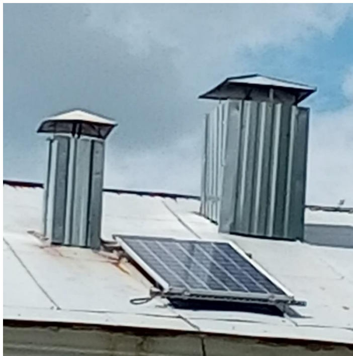
Рисунок 1. Розташування фотоелектричної панелі AS-6P-340W на даху
