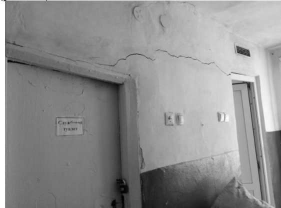
б) – тріщини в коридорі сан.тех. блоку
