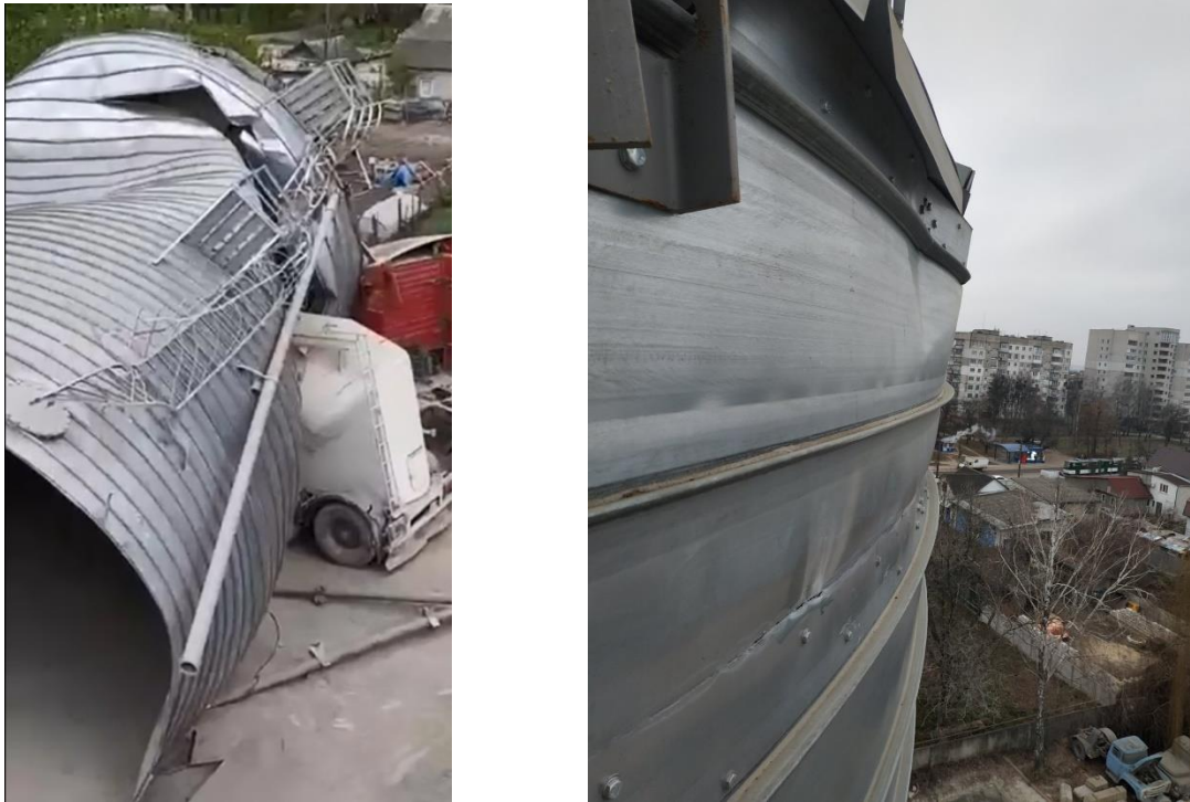
Рис. 5.29. Аварії силосів спіральньо-фальцевого типу:
