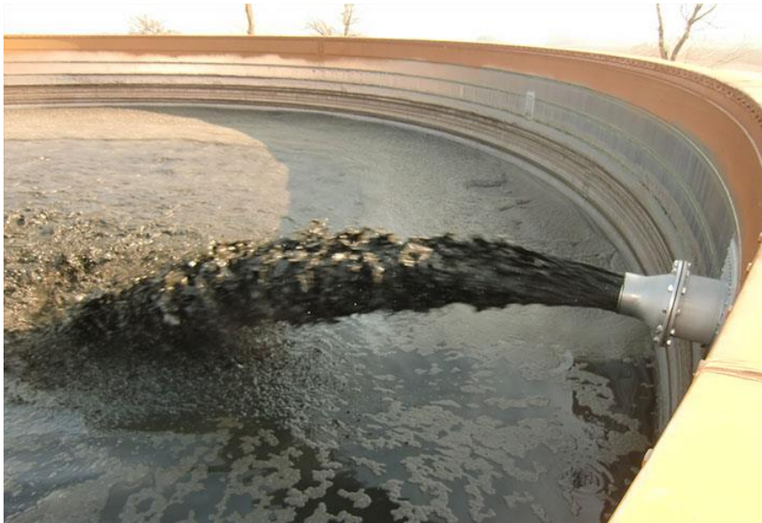
Рис. 2.13. Резервуари для зберігання рідкого добрива
