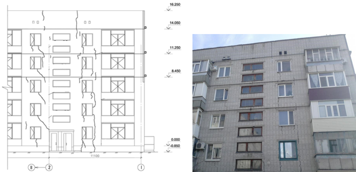
Рис. 12. Схема розміщення дефектів і пошкоджень у кладці зовнішніх стін на фасаді 2-І (зліва) і їх фото (справа) за даними моніторингу
