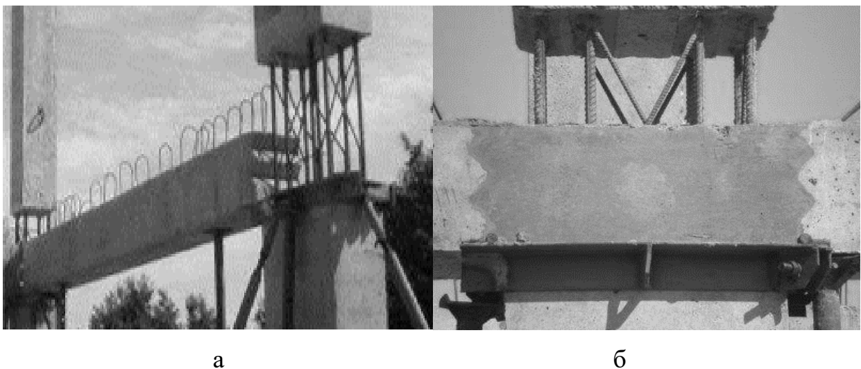
Рисунок 1.14 – Шпонковий профіль на торцевих поверхнях збірних елементів ригелів (а) і стик ригеля з колоною (б)
