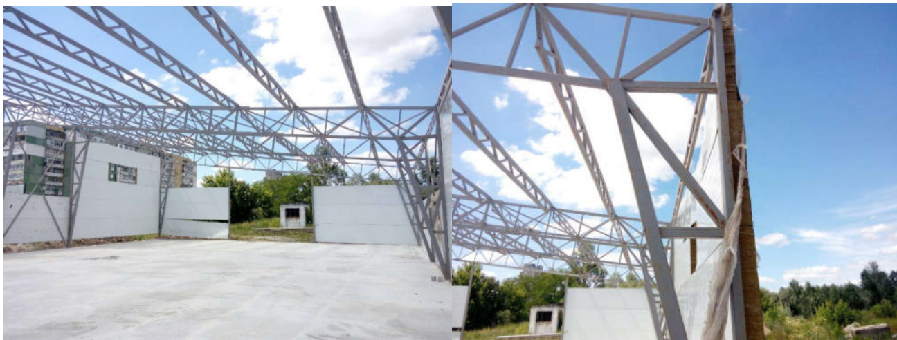
Рисунок 4.7 Сталевий каркас будівлі який потребує підсилення.
