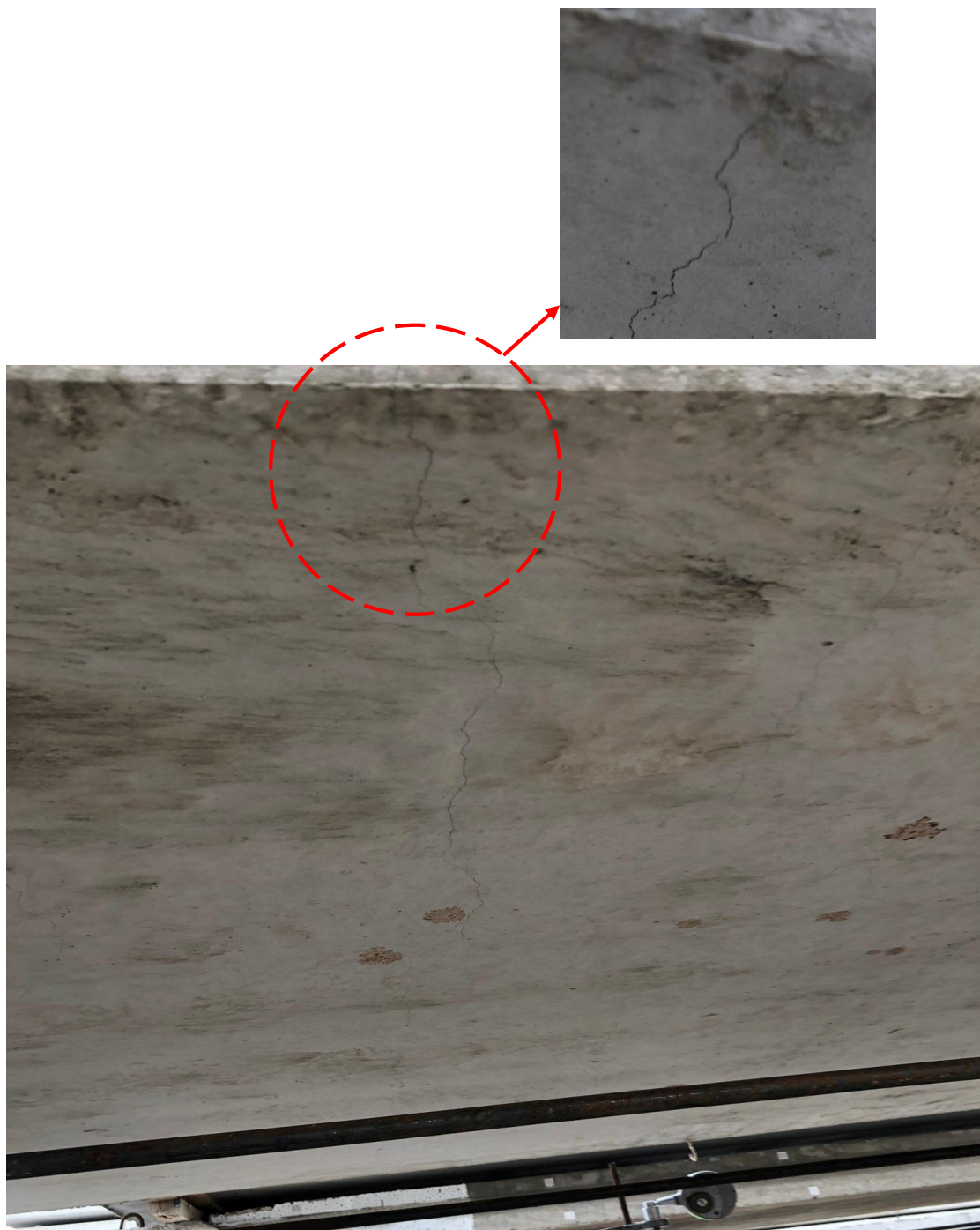
Рис. 5.20. Тріщина на нижній грані ПМК
