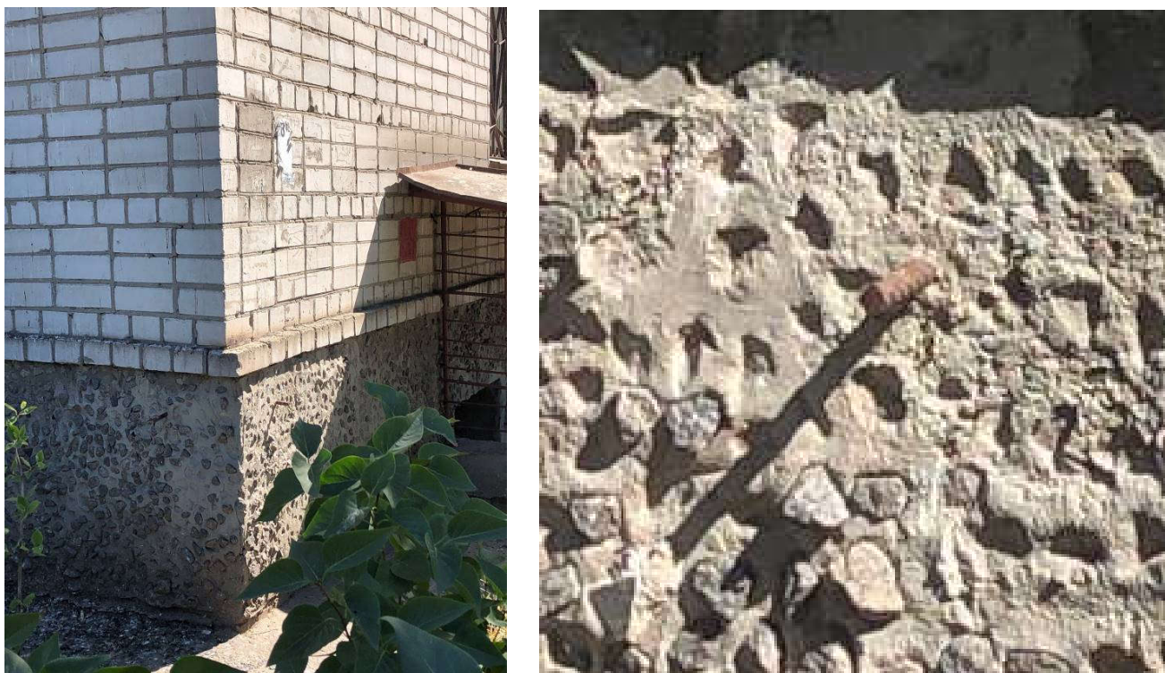
Рис. 2.14. Стінові осадочні марки
