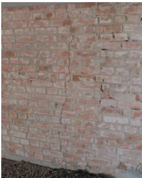
Рис. 5.10. Вертикальна осадова тріщина на рівні технічного поверху
